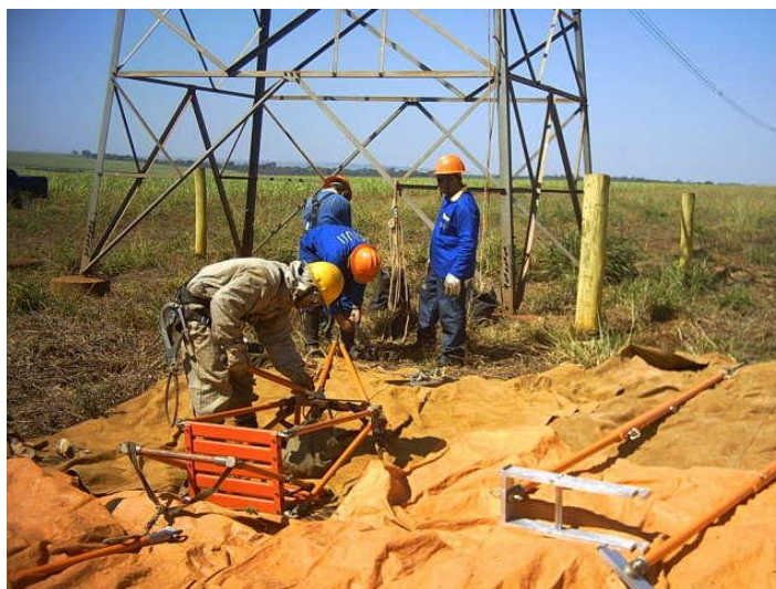
Foto 3. Cadeira de translado sendo montada para utilização nas manobras de troca de isoladores.
