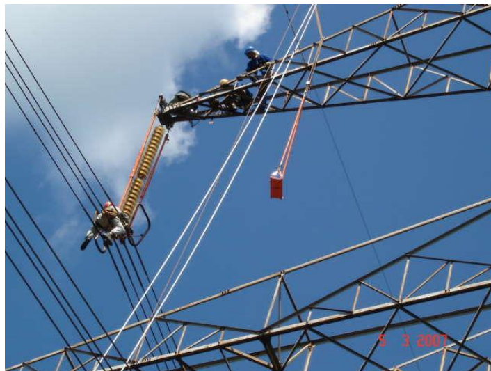
Foto 7. Balancim que substituiu a cadeira de traslado sendo utilizado e cadeia de isoladores com um isolador quebrado.
