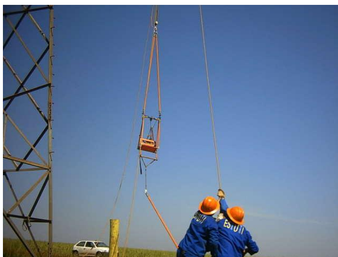
Foto 4. Cadeira de translado já montada pronta para uso nas manobras de troca de isoladores.
