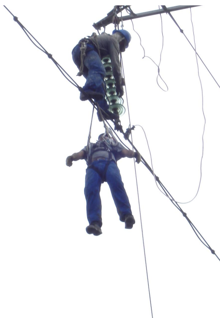
Foto 1. Treinamento para resgate de eletricista acidentado em linhas de transmissão. O eletricista de capacete azul esta descendo no cabo condutor da LT para desconectar o eletricista “desmaiado” do cabo condutor e conectar-lo na corda de resgate.
