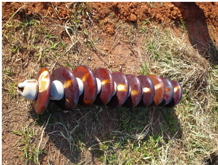
Foto 9. Cadeia de isoladores queimada por descarga atmosférica.
